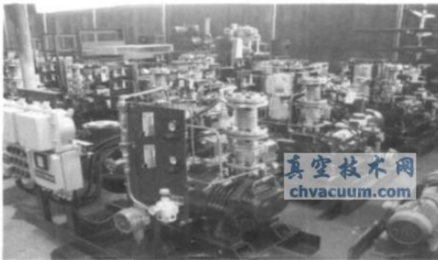
图 15 溶媒回收螺杆真空泵
